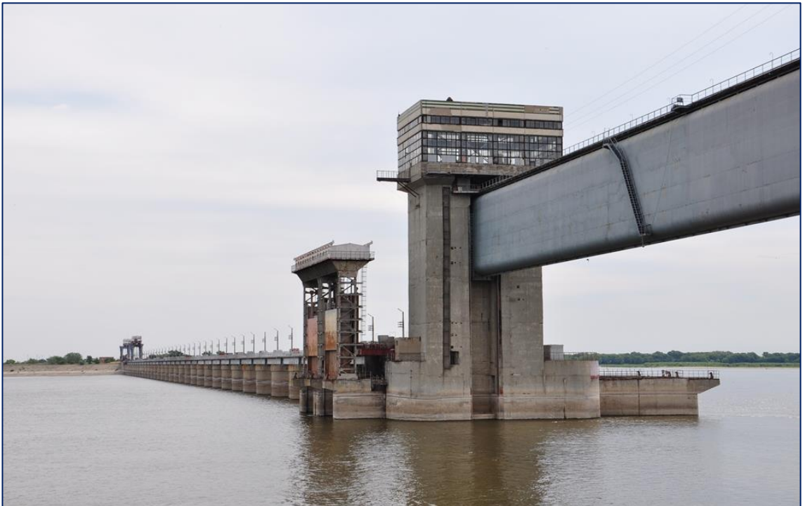
Рис. Б.6 – Фото вежі судноплавного та бічних регуляційних прольотів Астраханського вододільника з боку верхнього б'єфу (2013 р.) [33]
