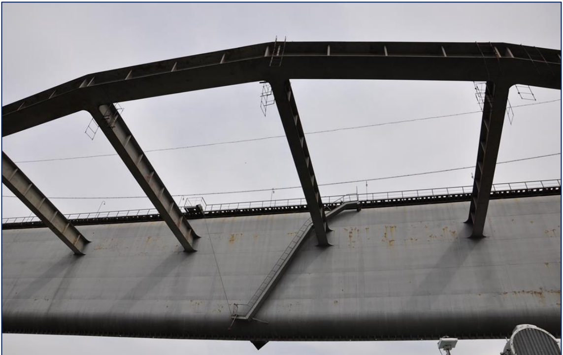
Рис. Б.8 – Фото піднятої заслінки судноплавного прольоту Астраханського вододільника з боку нижнього б'єфу (2013 р.) [33]
