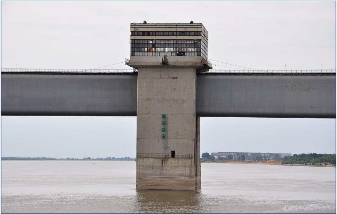
Рис. Б.5 – Фото центральної вежі Астраханського вододільника з боку верхнього б'єфу (2013 р.) [33]
