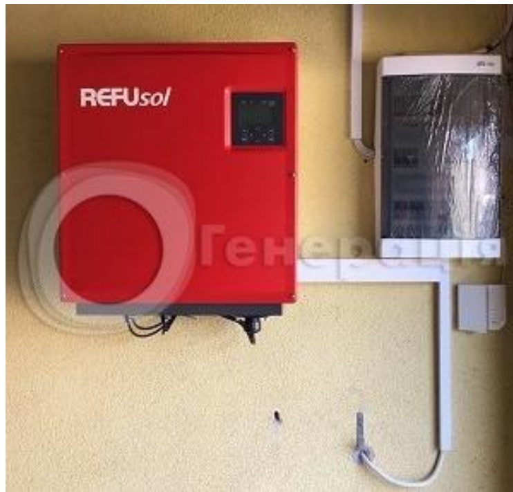
Рисунок 4.33 - Новий електричний щит і інвертор
