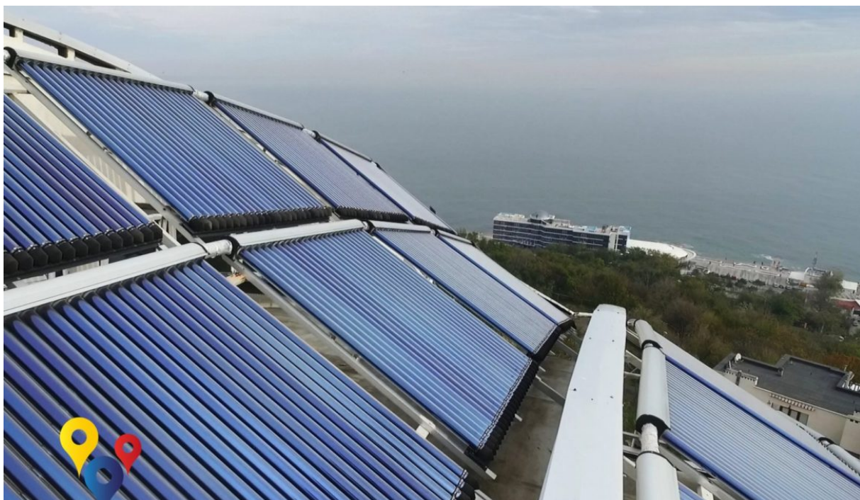
Рис. 5.3 – Приклад використання сонячних панелей на даху будинка по вул. Лева Качинського.
