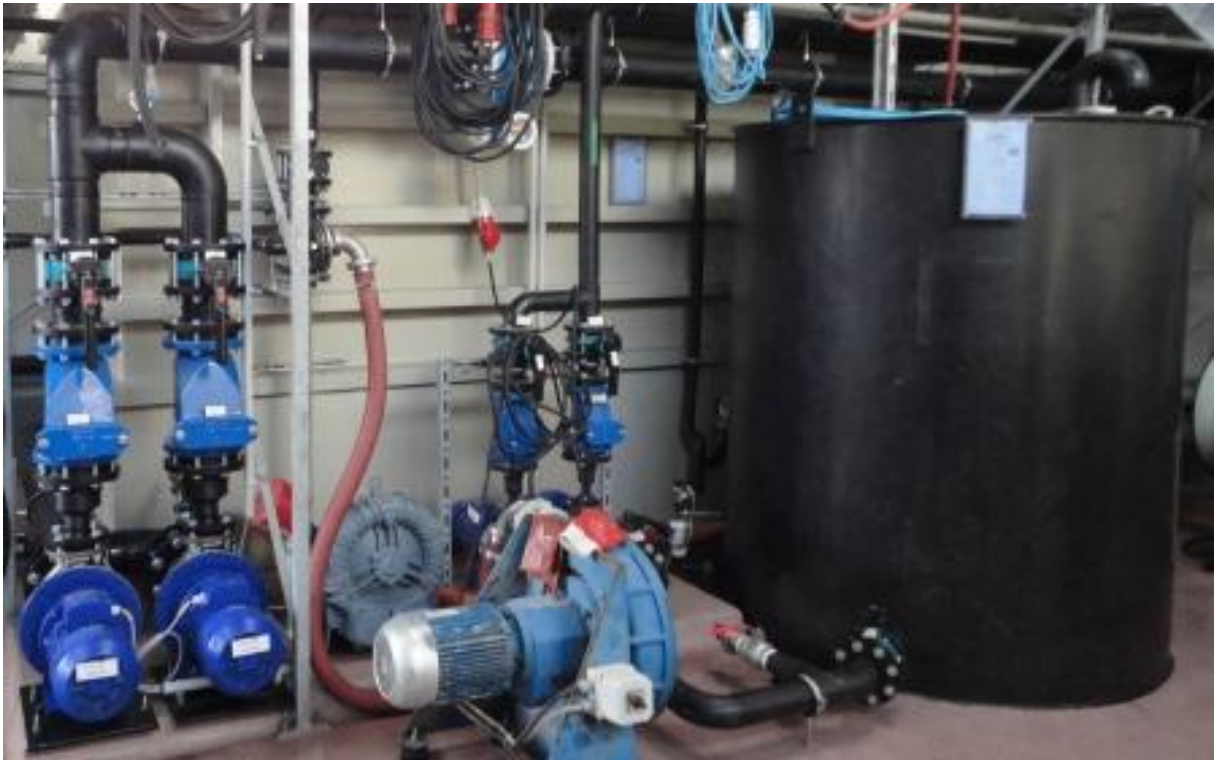
Рис. 4.4 - Ємність очищеної води і насосна станція
