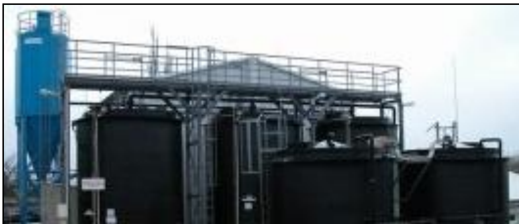
Рис. 7.3 – Станція механічного очищення стічних вод
