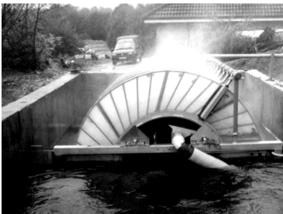
Рисунок 8.4 – Механічний барабанний фільтр встановлений на водоподавальному каналі рибницького господарства
