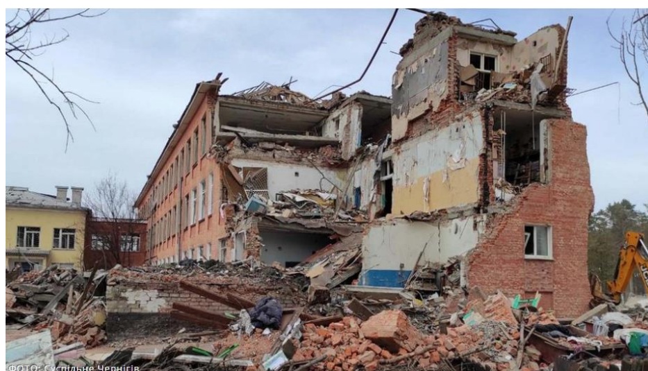
Рисунок 3.10 – Наслідки обстрілу об'єкту КП «Чернігівводоканал» [44, 45]
