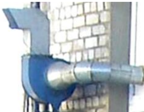
Рис. 8 - Вентиляторний пиловловлювач вагонного депо
