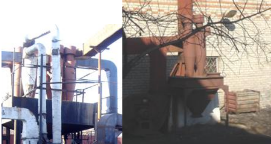
Рис. 11 - Фільтруюча установка циклон на котельнях вагонного депо
