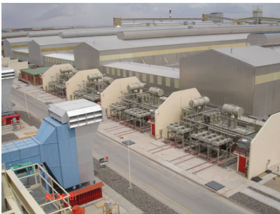
Рис. 4.1. Приклад підстанції для заводів з виробництва алюмінію
